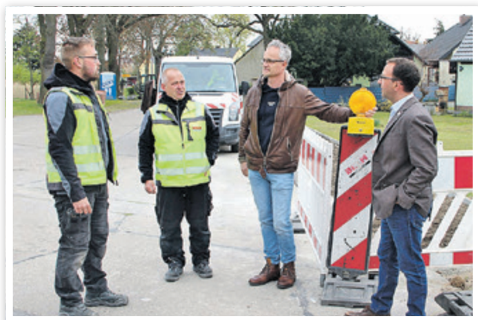
Bürgermeister Stefan Scheddin, Tiefbauamtsleiter Sascha Schmidt und Mitarbeiter der Firma BELM aus Ruhlsdorf bei der Baubesprechung.
