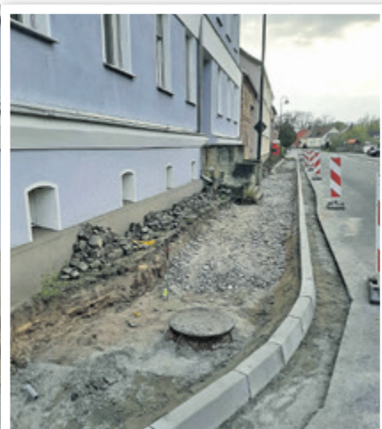
Bauarbeiten am Gehweg in der „Baruther Straße“ in Stülpe im Mai dieses Jahres.
